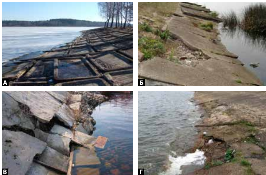
Рис. 5. Характерные разрушения железобетонных креплений откосов водохранилищ: А – Заславского; Б – Чигиринского; В – Лепельского; Г – Любанского
