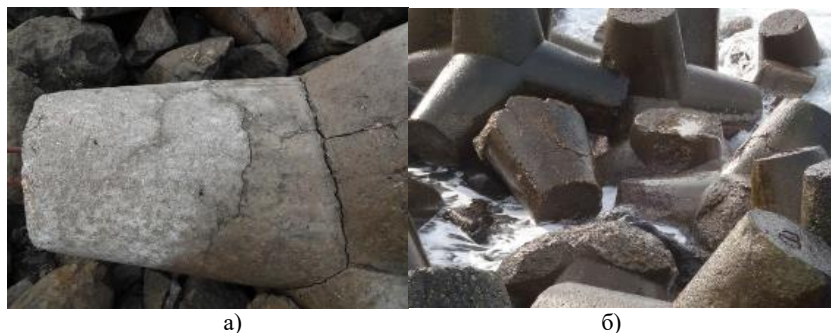
Рисунок 3. Вид разрушения P_T у тетраподов на объекте X2-1: a – раскрытие трещин в бетоне; б – последующее разрушение на отдельные фрагменты от воздействия прибойной волны
