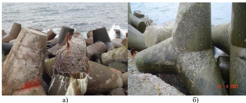
Рисунок 1. Виды разрушения бетона в тетраподах после 45 лет эксплуатации: а – объемное разрушение; б – поверхностное разрушение в виде шелушения
