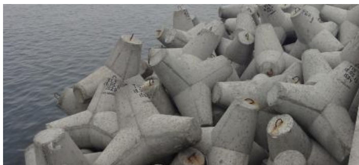
Рисунок 7. Точечное поверхностное разрушение бетона после первого зимнего сезона на объекте K3-2
