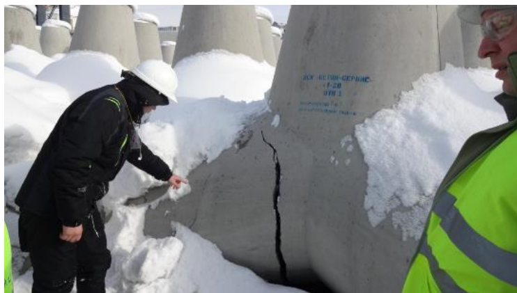
Рисунок 8. Вид разрушения P_T у тетраподов Т-20 на объекте ХЗ-3: раскрытие трещин в бетоне и последующая фрагментация
