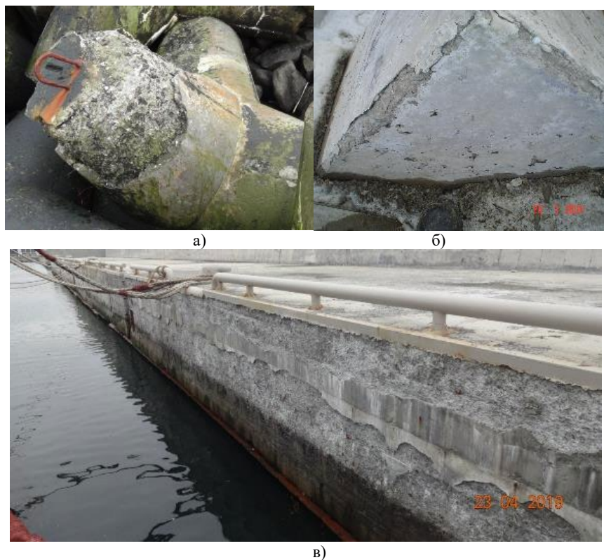
Рисунок 2. Вид разрушения P_C – отслоение поверхностной части бетона с последующим объемным разрушением внутренних слоев бетона: a – конструкция (тетрапод) после 40 лет эксплуатации на объекте X2-1; б – конструкция (гексабит) после первого зимнего сезона на объекте K3-1; в – конструкция причальной стенки после первого зимнего сезона на объекте K3-2
