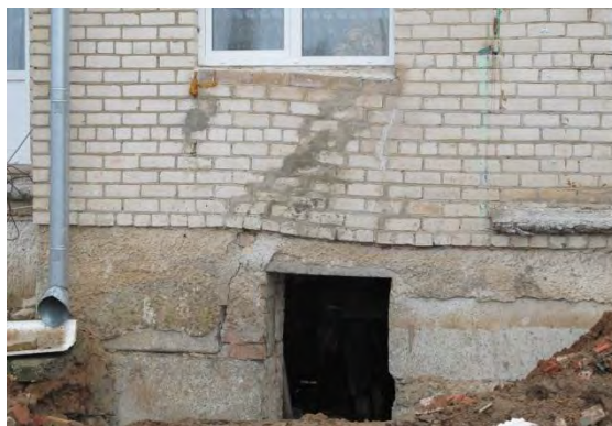
Рис. 2. Общий вид поврежденной стены (трещины заделаны раствором)
